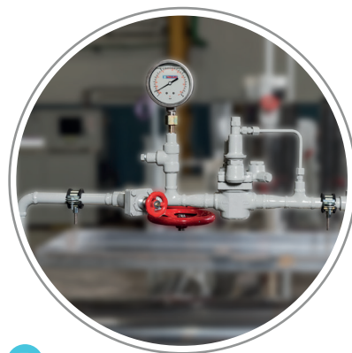
5 Cuadro de Presión Cte de Bombeo Constant differential pressure pumping valve station
