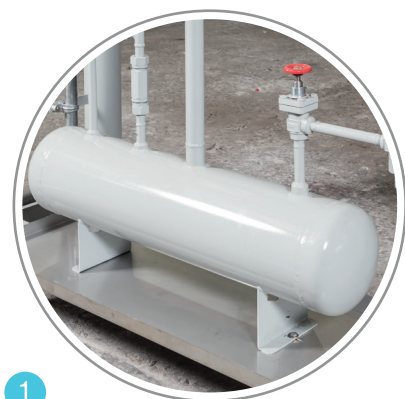
1 Tanque de Purga de Aceite Oil pot
