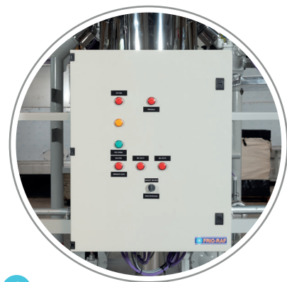
4 Tablero Eléctrico Electric panel
